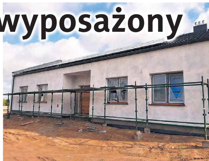
Obiekt będzie ogrzewany ekologicznie, pompą ciepła i panelami fotowoltaicznymi, które zostały zamontowane już na dachu.
