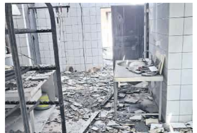
Wnętrze i dach spłonęły całkowicie. Foto. Malwina M.
