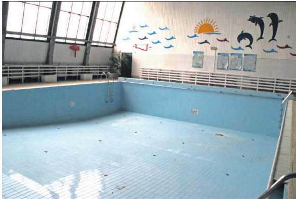
■ Nieczynny basen w Zespole Szkół Technicznych wymaga remontu, ale do jego przeprowadzenia niezbędne są środki zewnętrzne
