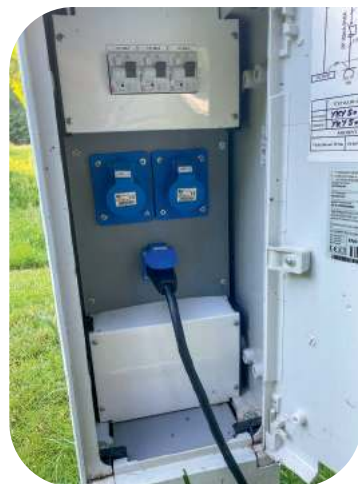
Słupki z dwoma przyłączami elektrycznymi CEE i jednym tradycyjnym
