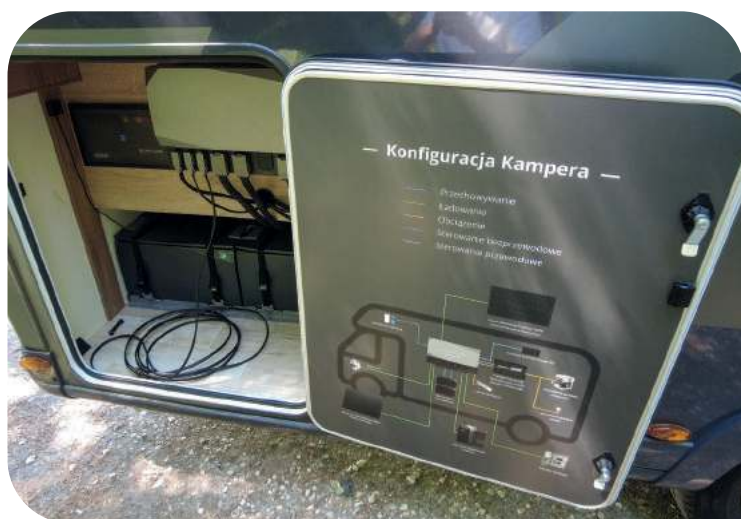
Serce systemu w tym modelu mieści się w garażu. Mamy 2 akumulatory, panel dystrybucyjny oraz wielofunkcyjny hub, który rządzi i dzieli w całej tej układance
