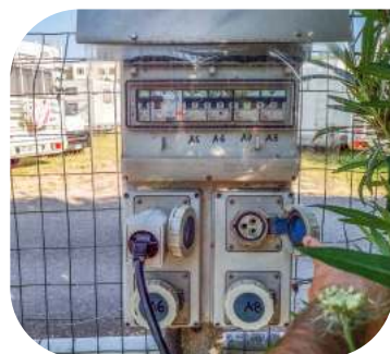
Słupki z przyłączami elektrycznymi CEE na włoskim kempingu. W jednym z gniazd widać wpiętą przejściówkę – adapter na klasyczną wtyczkę 230 V
