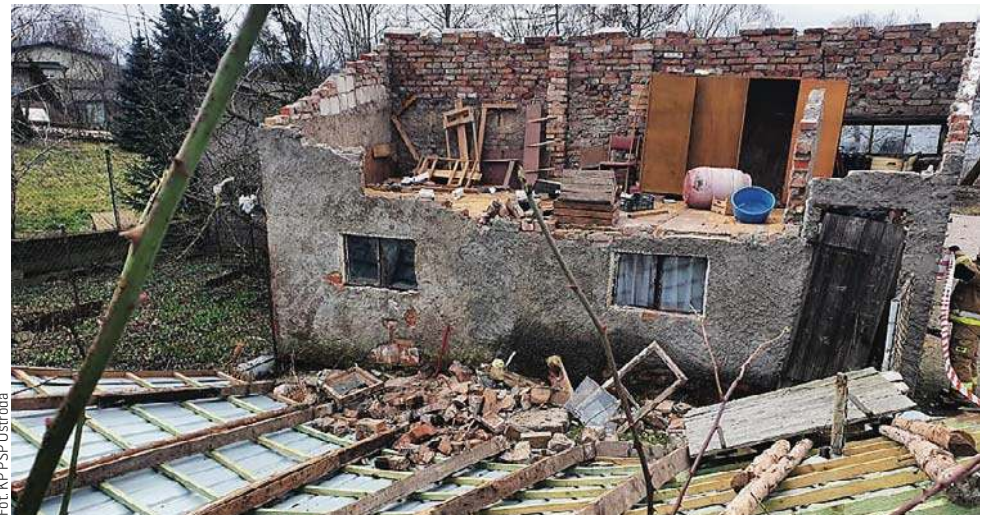
Uszkodzony budynek w powiecie ostródzkim
