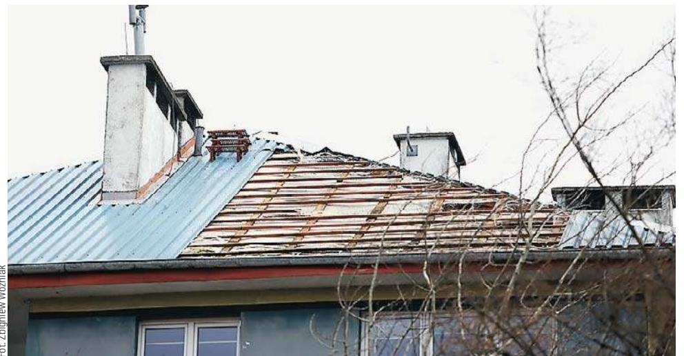
Zerwany dach na ulicy Mroza w Olsztynie
