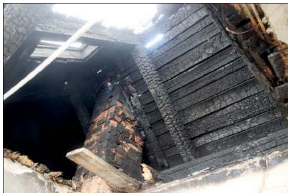
Mieszkańcy obawiają się, że mimo zabezpieczenia dachu plandeką, spadający deszcz może wyrządzić kolejne szkody w ich domu
