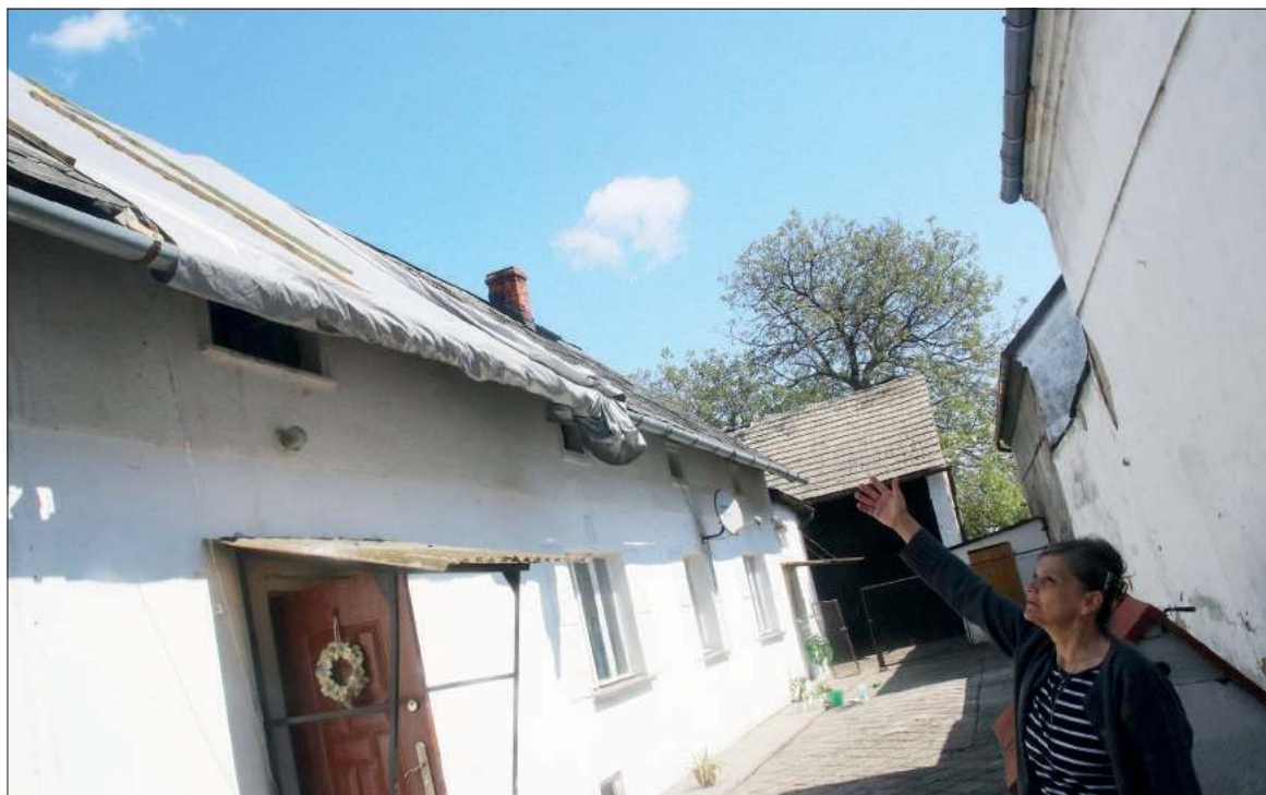
To część dachu, która się paliła
