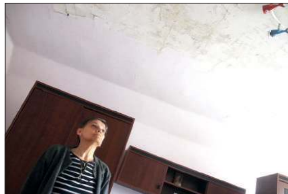
To pokój, w którym dawniej mieszkał syn małżeństwa. Sufit został zalany wodą, w chwili gaszenia pożaru
