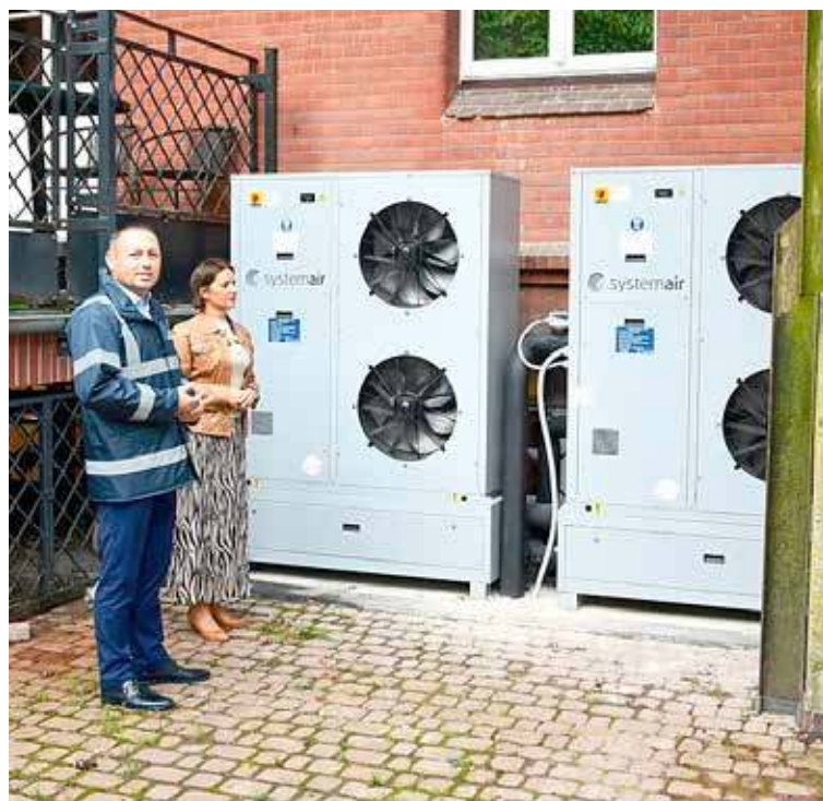
Przy budynku zostały m.in. zainstalowane nowoczesne systemy
