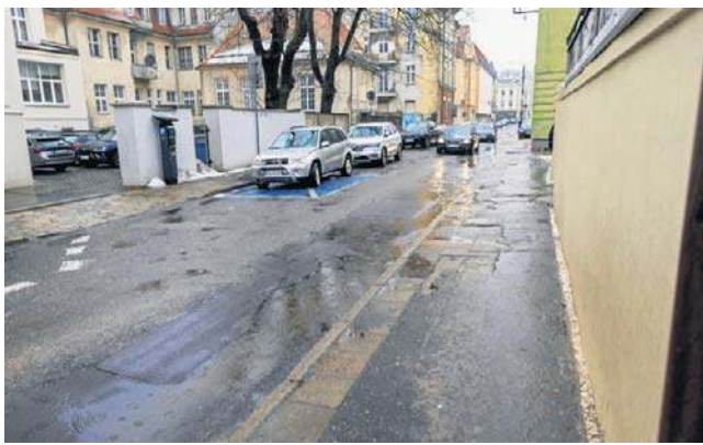
Ulica Murarska już od dawna wymaga remontu
