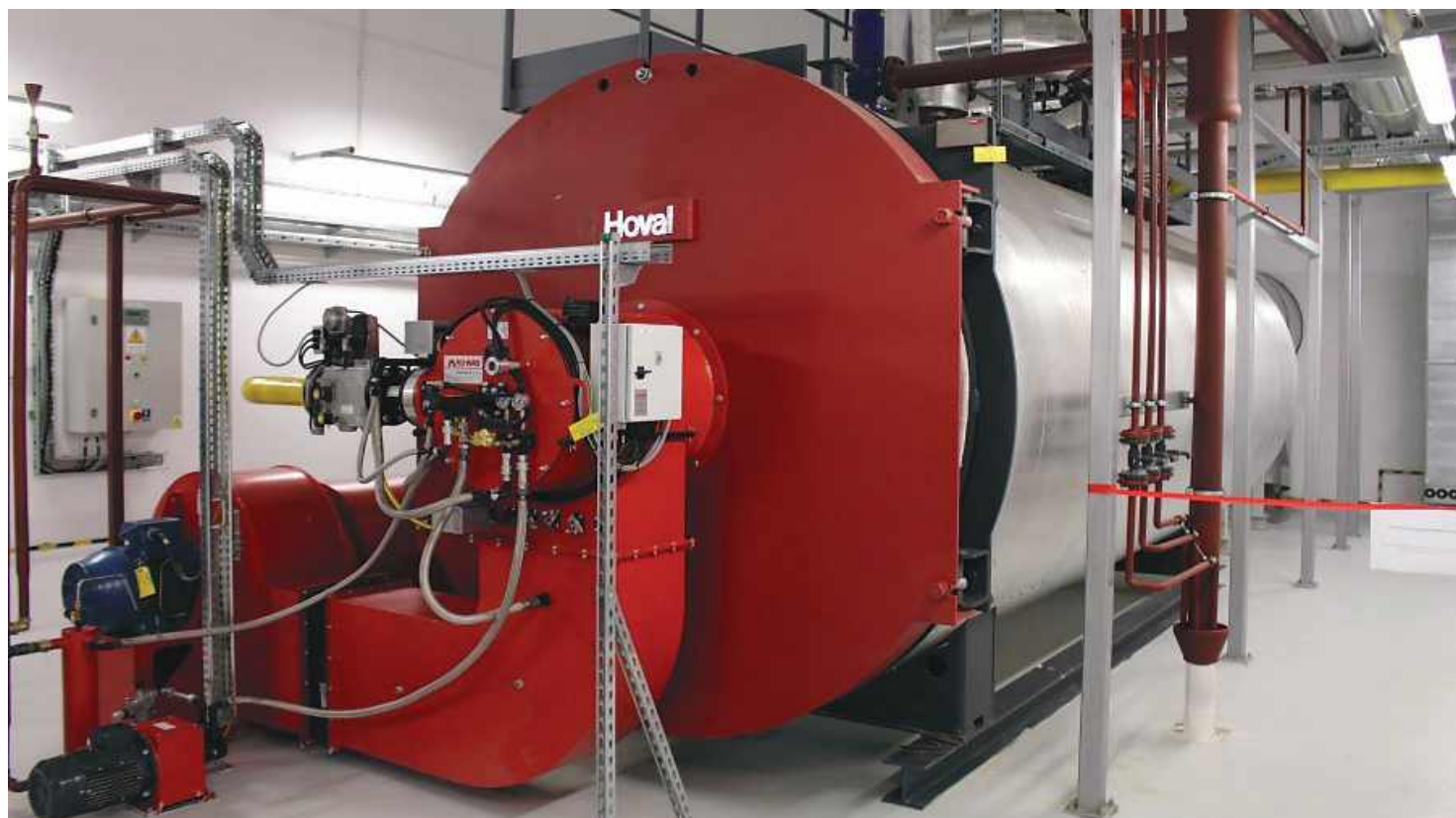
Kocioł szczytowy gazowo-olejowy
