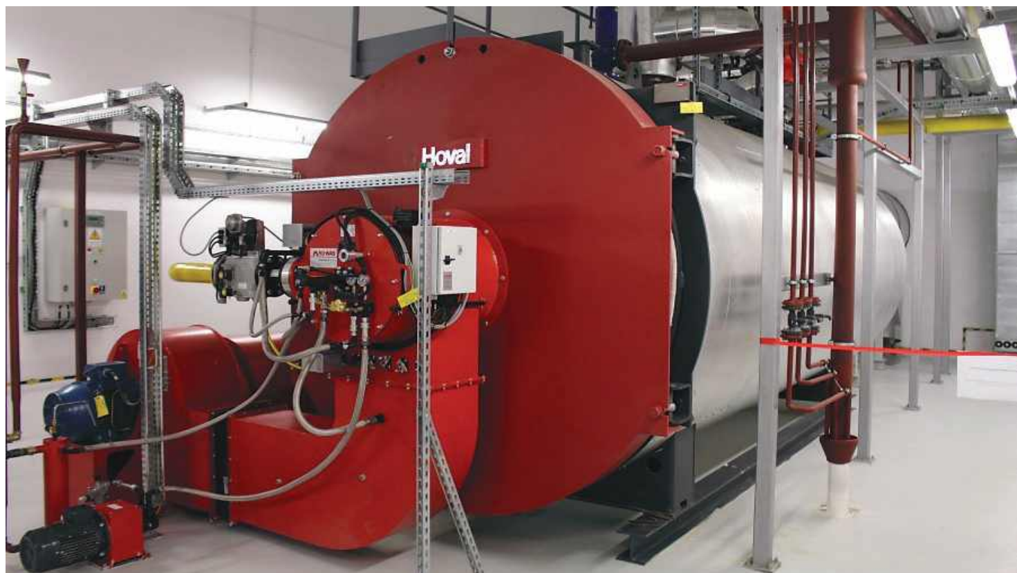
Kocioł szczytowy gazowo-olejowy
