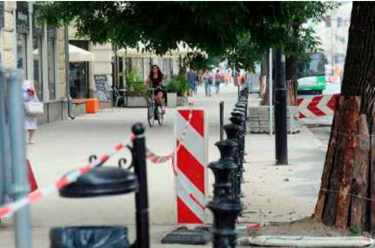
Świeżo ułożoną kostkę w wielu miejscach jesienią trzeba będzie rozebrać
