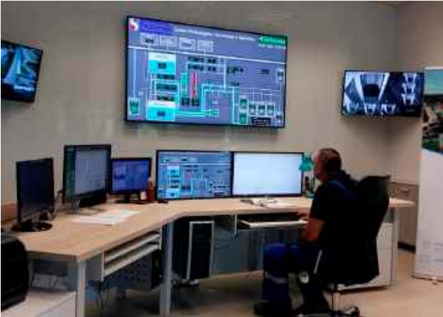
Tak wygląda dyspozytornia zmodernizowanej magistrali
