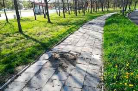
Na chodniku na przechodniów wciąż czyhają takie pułapki. Wkrótce ma się to zmienić...
