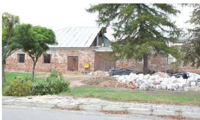
Zabytkowy ratusz nie ma już wieży strażackiej i połowy dachu
