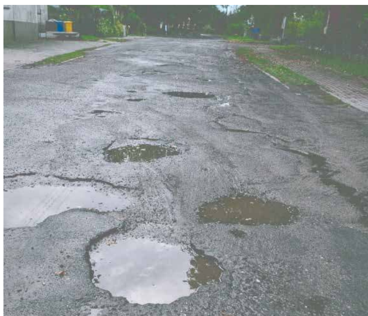
Wiele dróg szczególnie tych położonych na terenie wiejskim ostatnie poważniejsze prace przeszły w latach 70-tych i 80-tych zeszłego stulecia
