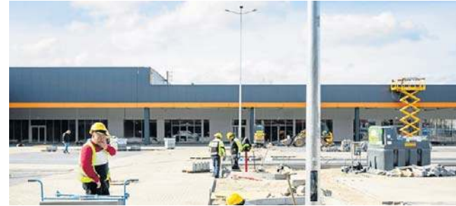
W miejscu dawnego centrum handlowego Glinki finiszuje budowa Comfy Parku o powierzchni 16 000 m kw
