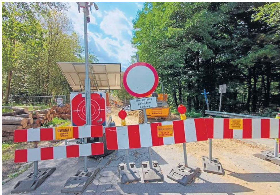
Ruchliwa droga w kierunku Tresnej została zamknięta pod koniec lipca
