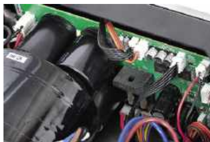
Nad transformatorem "wiszą" pozostałe elementy zasilania, prostowniki i kondensatory filtrujące.
