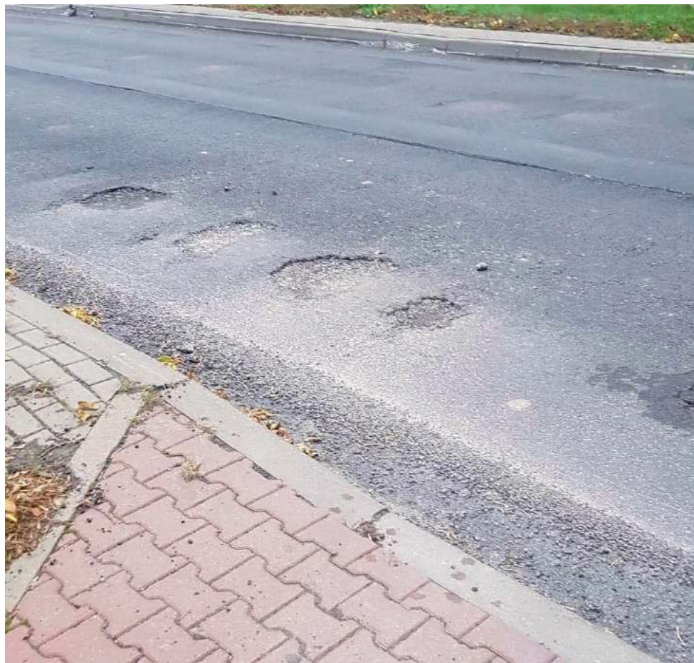
A tak wygląda „nowy” asfalt na Kościuszki
