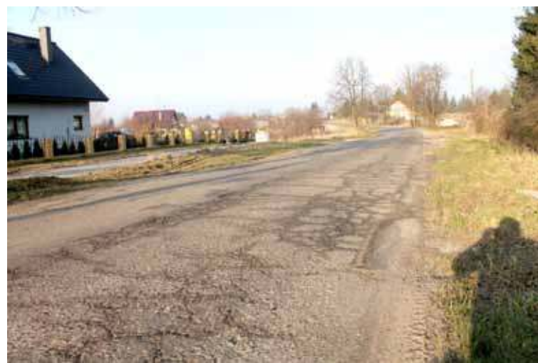
Na ul. Morskiej oprócz remontu drogi przydałoby się także budowa chodnika, gdyż obecnie jest on tylko z jednej strony
