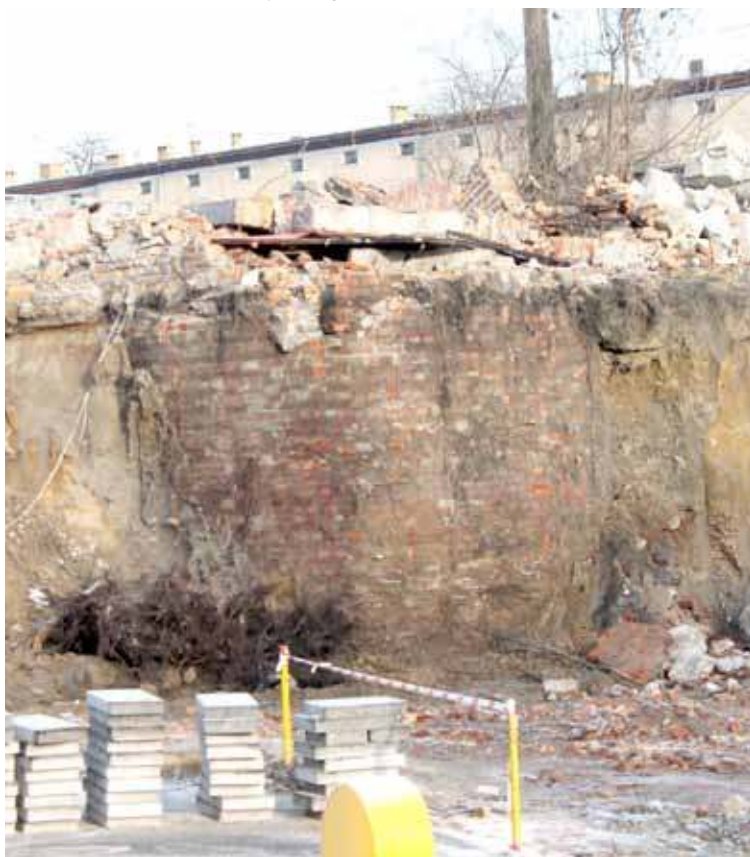
Jak informuje PKP PLK widoczna na zdjęciu ściana ulegnie rozbiórce
