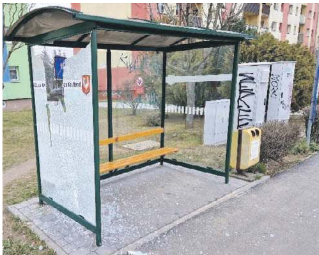
Zniszczona wiatka na przystanku przy ul. Iwaskiewicza
