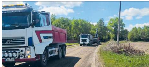
Zgodnie z planem Zarządu Dróg Powiatowych w Białej Podlaskiej, termin zakończenia wszystkich prac przewidziany jest na 10 listopada 2025 roku
