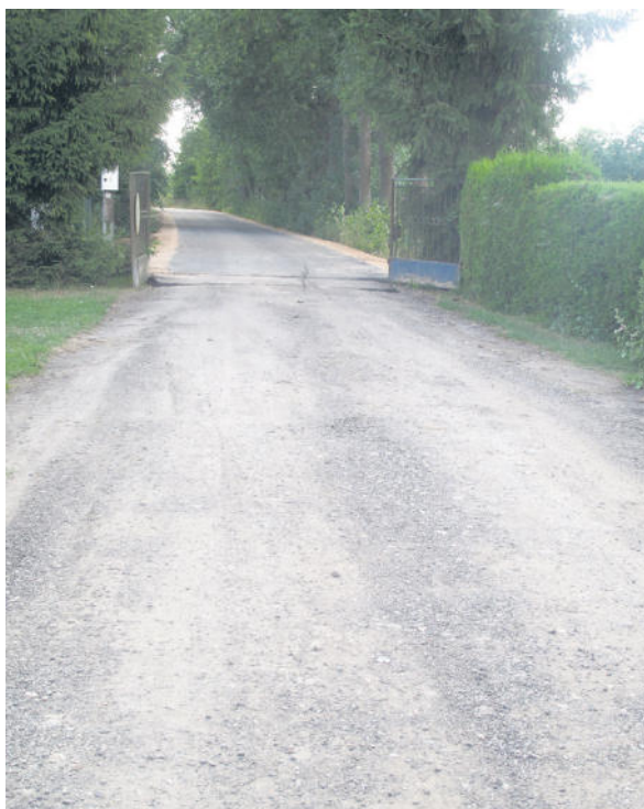
Droga w Topórku. Tyle asfaltu zabrakło
