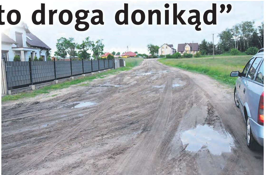
Skrzyżowanie drogi powiatowej na Ciechocin z drogą powiatową Żalno – Tuchółka. W tym miejscu samochody firmy transportowej mają problem z wyjazdem.
