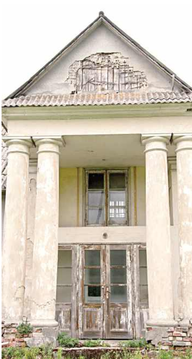
Obiekt jest zniszczony, ale władze gminy chcą mu przywrócić blask
