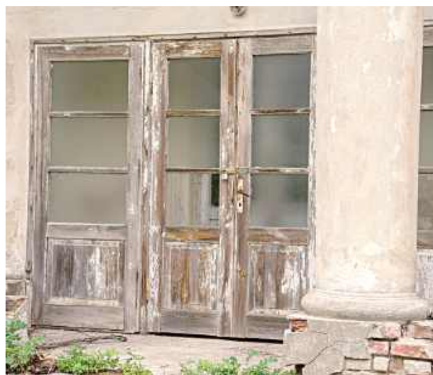
Po budynku widać upływ czasu
