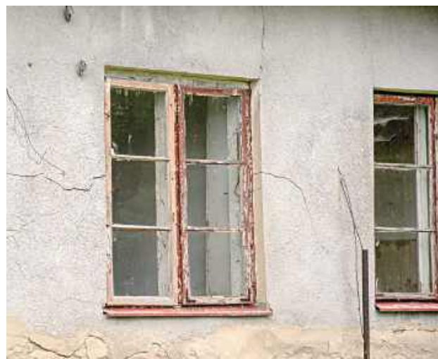
Budynek wymaga kapitalnego remontu
