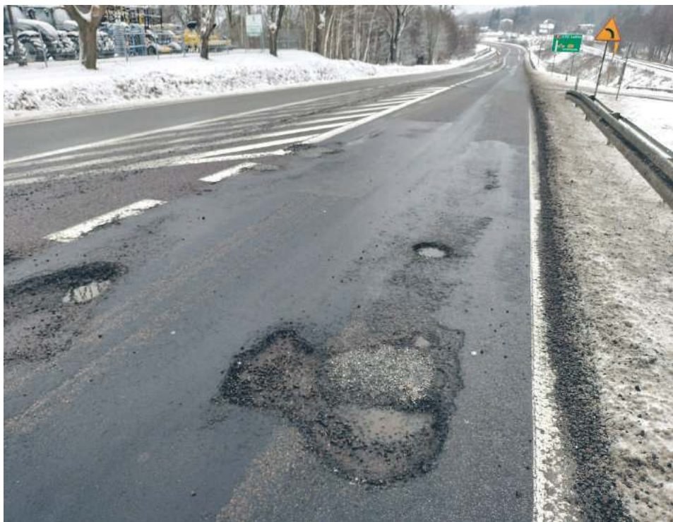
Dziury na DK17 na odcinku Krasnystaw – Izbica
