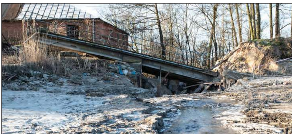
■ Przyczyn zawalenia mostu mogło być kilka. Za duże spiętrzenie wody, albo jakieś czynniki zewnętrzne np. bobry, które podkopywały groble, na której wsparta była konstrukcja. Nie można też wykluczyć, że do katastrofy przyczyniły się cięższe samochody, które przejeżdżały wtedy podczas budowy trasy S17
