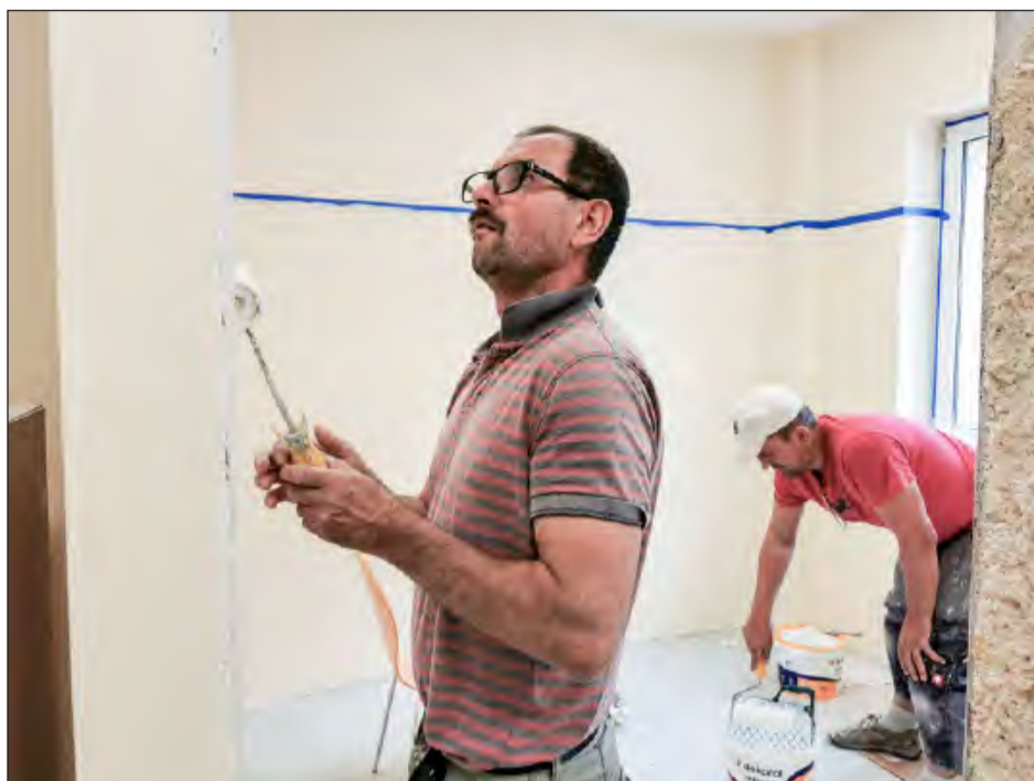
Trwają prace adaptacyjne pomieszczeń. Zajmuje się nimi firma URB Dariusza Siudaja z Żyrzyna, która wygrała przetarg. Koszt remontu to 176 tys. zł (fot. OPS Ryki)
