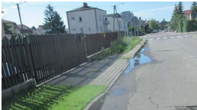
Po niedzielnym deszczu została już tylko mała kałuża. Jednak jeśli opady są poważniejsze, powstaje w tym miejscu rozległe rozlewkisko
