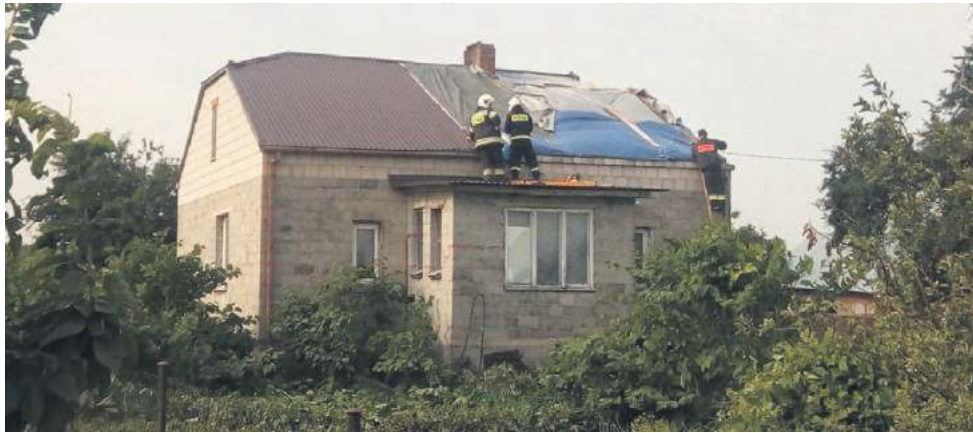
W Kłatwach (gm. Tyszowce) wiatr uszkodził dach domu.
