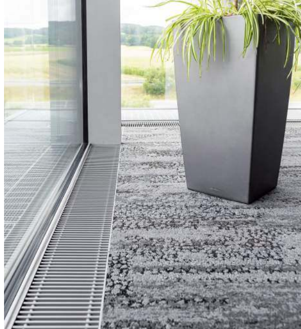
❶ Wysokość górnej krawędzi grzejnika z maskownicą trzeba idealnie dopasować do poziomu wykończonej podłogi. KAMPMANN
