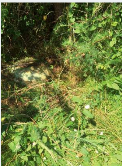
Raz w roku służba asenizacyjna unosi pokrywę, wyjmując kosz filtracyjny, myje elementy i wewnątrz osadnika gnilnego.
