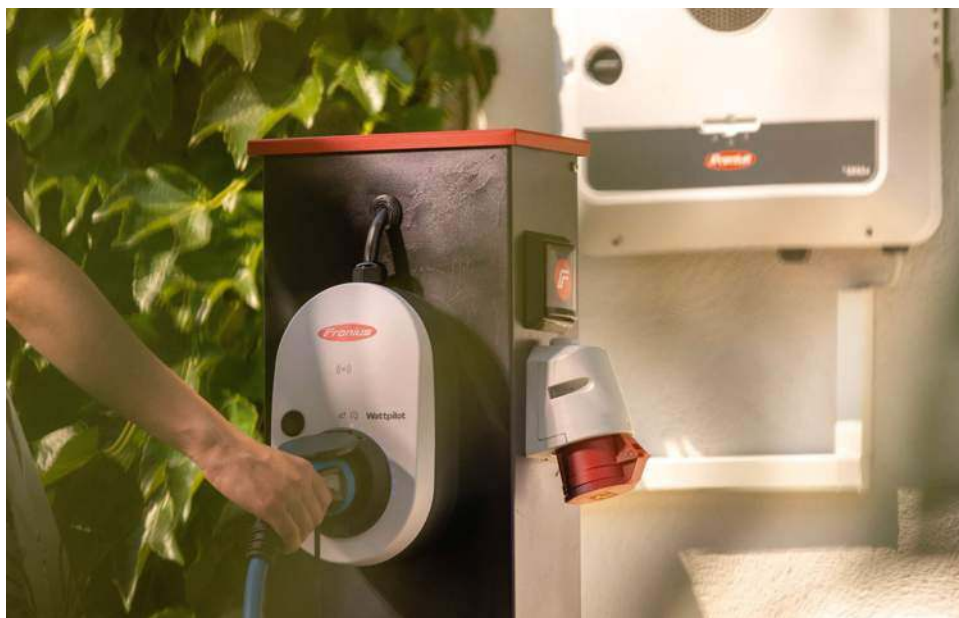
Współpraca stacji ładowania Fronius Wattpilot z instalacją fotowoltaiczną. Źródło: Fronius Polska
