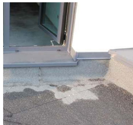
🔧 Woda przeciekała nie na połaci dachowej, a wyżej, przy obróbkach na styku ściany i attyki. Dlatego przeciek pojawiał się tylko przy większych ulewach. J. WERNER
