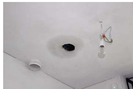
🔧 W domu było go widać jako mokrą plamę obok otworu wentylacyjnego na suficie w kuchni. J. WERNER
