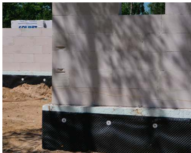
🔑 O prawidłową izolację strefy cokołowej warto zadbać także dlatego, że jej poprawienie jest znacznie trudniejsze, niż naprawa ocieplenia na wyżej położonych ścianach. A. PAPLIŃSKI
