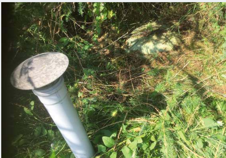
Elementy drenazowej oczyszczalni – pokrywa nad podłożnym zbiornikiem i kominiek napowietrzający.
