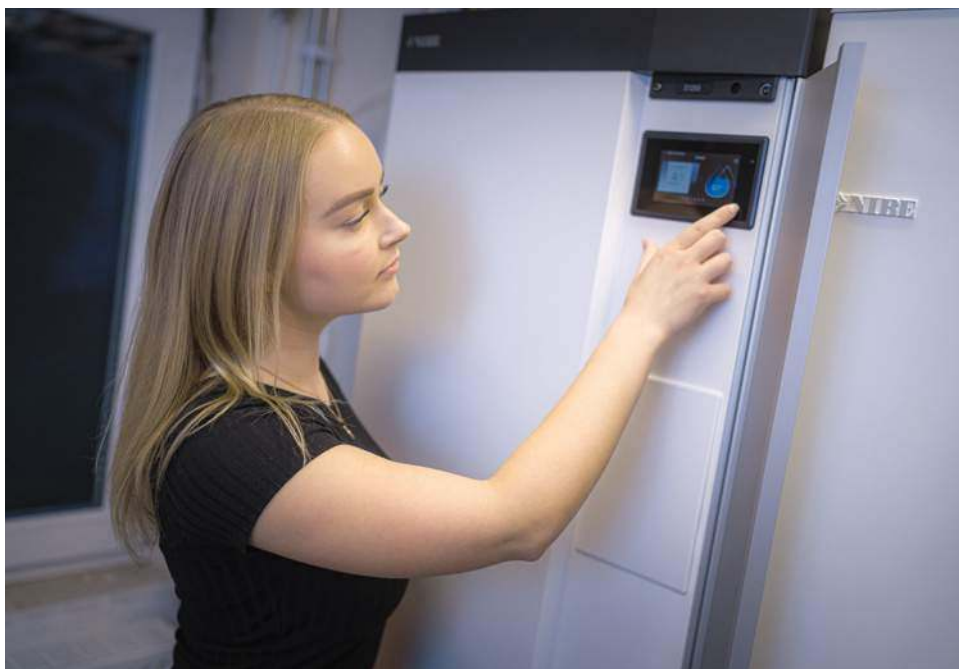
📌 Z punktu widzenia użytkownika, pompa ciepła to urządzenie w zasadzie bezobsługowe. NIBE-BIAWAR
