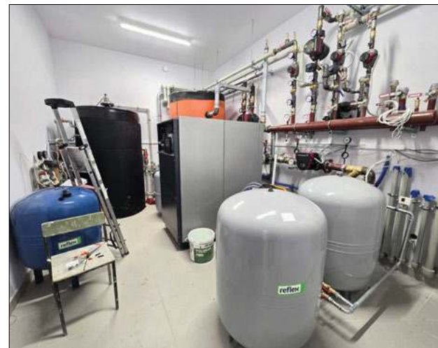
Budynek został wyposażony w nowoczesne rozwiązania, np. w pompę ciepła
