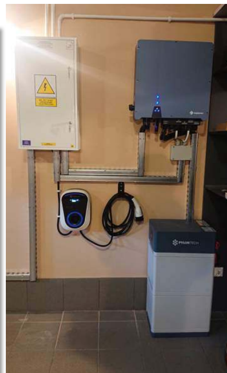
Hybrydowa instalacja PV z magazynem energii. RED MEN/SOLPLANET
