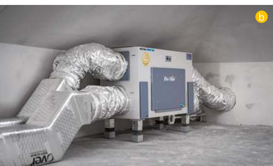
a Centrala wentylacyjna zajmuje tyle miejsca, co szafka. Umieszczamy ją daleko od sypialni – w garażu (a REKUPERATORY.PL), na strychu (b PRO-VENT).
