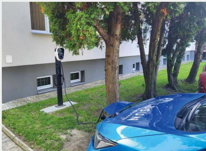
Instalacja wykonana przez firmę GoldSun w Zamościu
