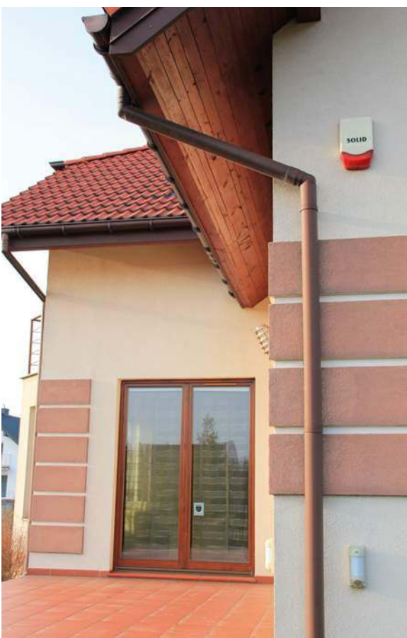
🔗 Niejako na końcu instalacji alarmowej znajdują się sygnalizatory i urządzenia powiadamiania, które emitują sygnały dźwiękowe i błyski świetlne. J. WERNER
