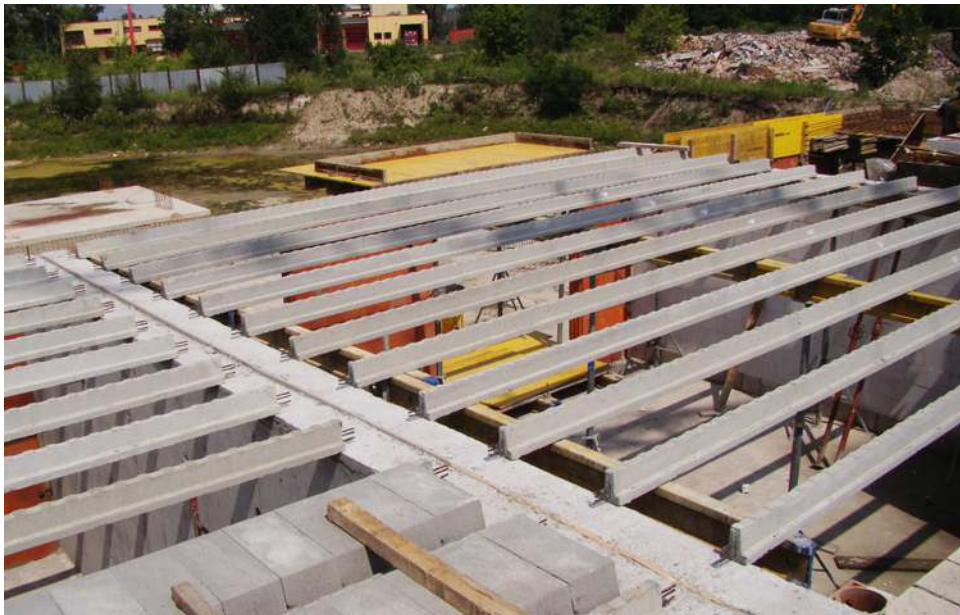
➤ Największą popularnością cieszą się obecnie stropy gęstożebrowe, które wyróżnia stosunkowo łatwy, niewymagający użycia ciężkiego sprzętu montaż. Ponadto materiały do ich budowy są powszechnie dostępne, a technologia jest dobrze znana wykonawcom. RECTOR
