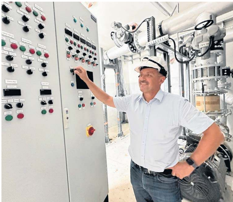
Nowa kotłownia to obiekt w pełni zautomatyzowany, na naprawdę światowym poziomie.
