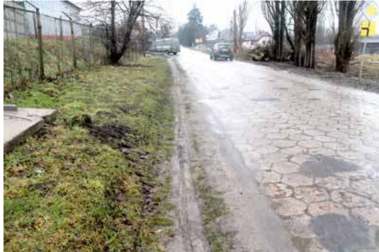
W tym miejscu, czyli przy skrzyżowaniu z ul. Składową, brakuje chodnika
