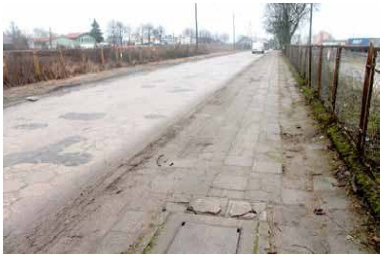
Stan chodnika też pozostawia sporo do życzenia
