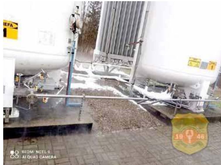
23 stycznia strażacy odebrali zgłoszenie o ulatniającym się gazie ze zbiorników, które znajdują się w Inisku przy ul. Sienkiewicza. Foto. OSP. Inisko
