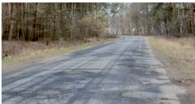
Gołym okiem widać, że nawierzchnia aż prosi się o wymianę. Skorzystają na tym również kierowcy
