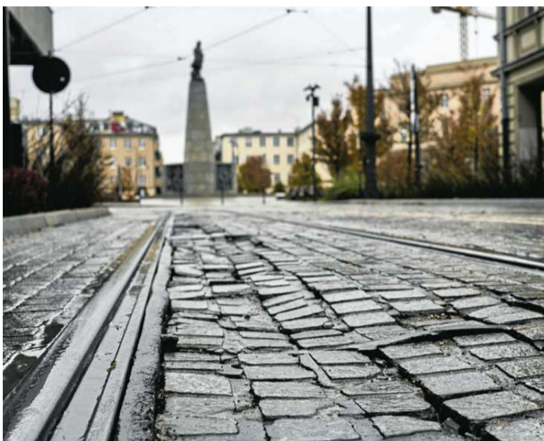
• Uszkodzona i pozapadana kostka na nowo wyremontowanych ulicach Łodzi. FOT. TOMASZ STAŃCZAK / AGENCJA WYBORCZA.PL
