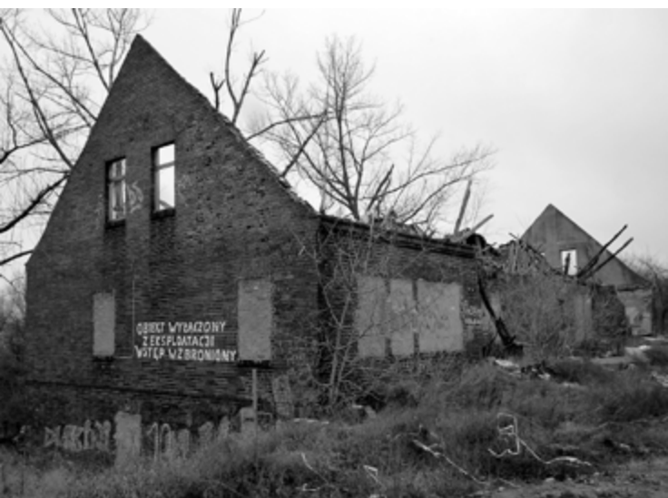
Fot. 5. Rozmaite czynniki fizyczne i psychofizyczne mogą sprawiać, że osoba przebywająca w zrujnowanym budynku ulegnie nastrojowi grozy.
