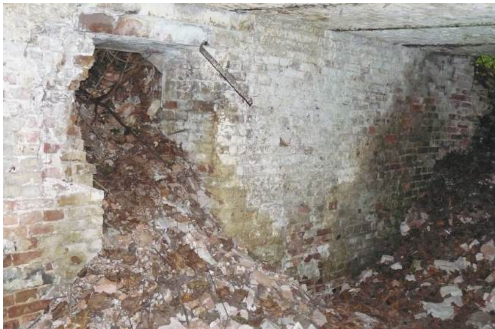
Stan piwnic dużego pałacu w Górze
