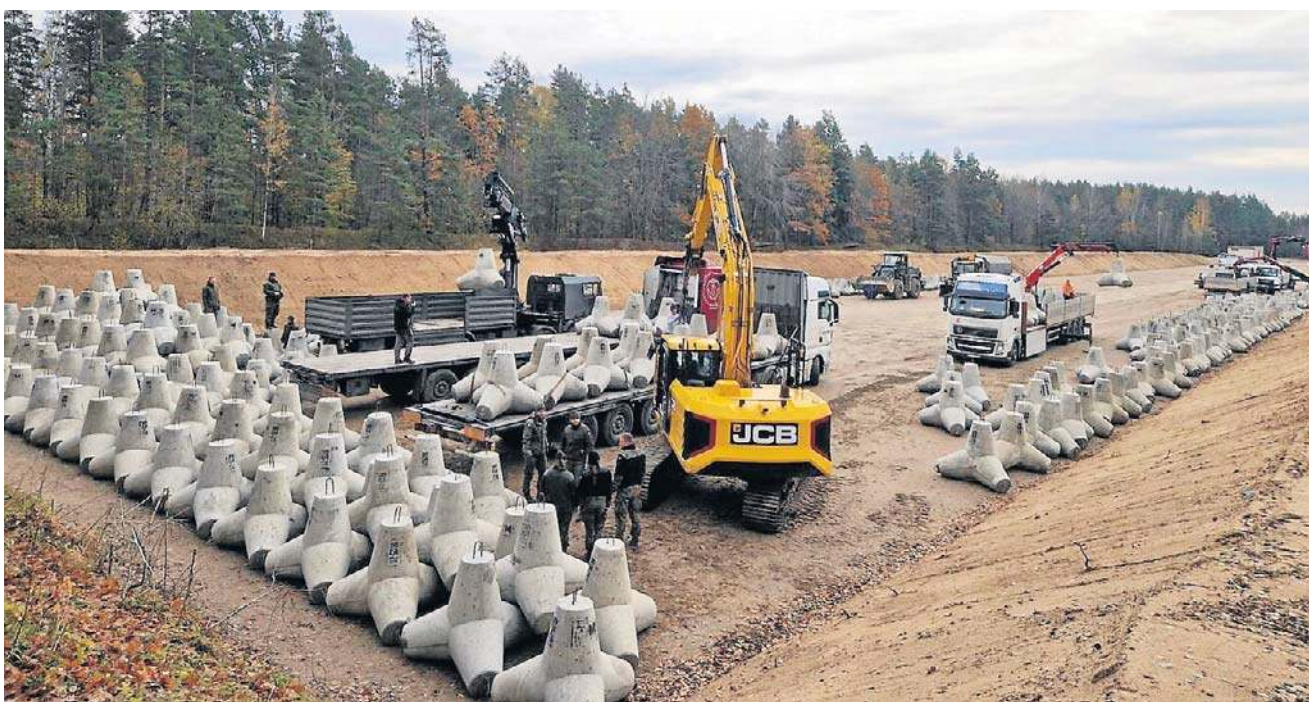
Umocnienia „Tarczy Wschód” to nie tylko fizyczne zapory (na zdjęciu), ale i zaawansowane systemy elektroniczne
