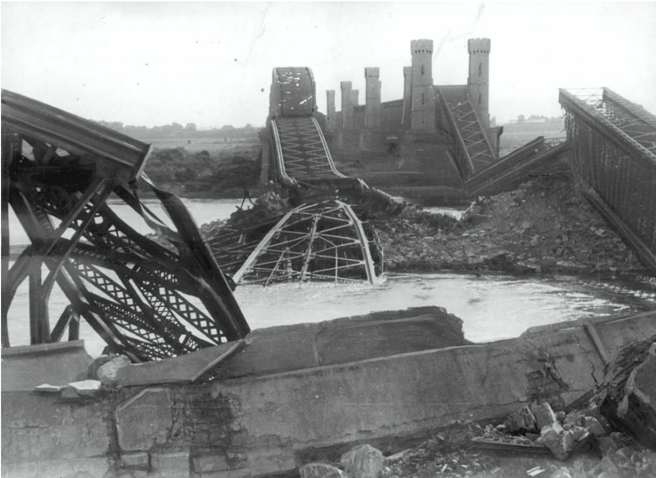
▲ Zniszczony tuż po wybuchu wojny most na Wiśle w Tczewie
