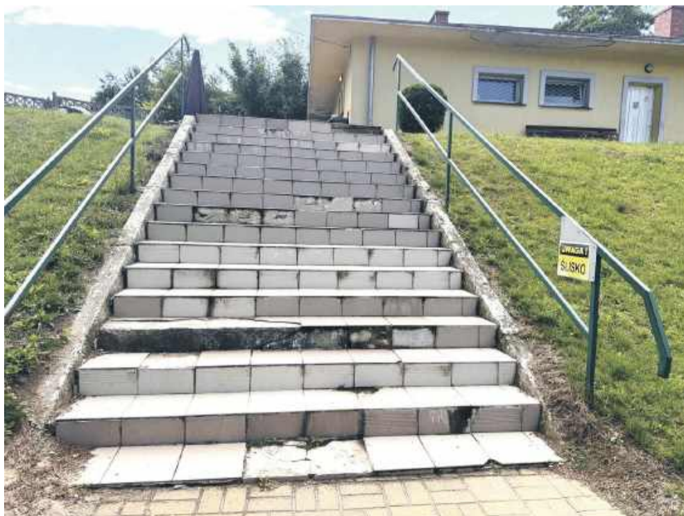
Obiekt sportowy może stwarzać spore zagrożenie. Tak wyglądają dzisiaj schody
