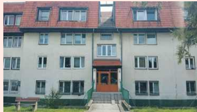
Uszkodzona deska zwisała nad tym wejściem
