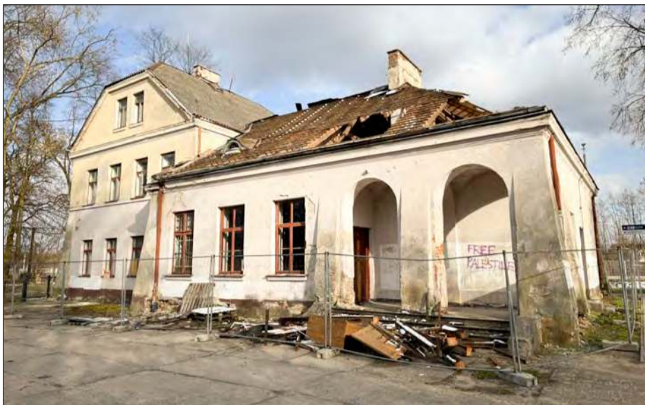
W piątek przy dworcu pojawiła się ekipa z zadaniem całkowitej rozbiórki. Rozpoczęto od usunięcia eternitu i więźby dachowej
