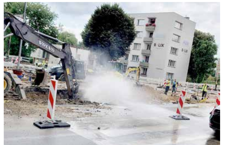
Do zdarzenia doszło w pierwszej połowie sierpnia na terenie budowy ronda. Konsekwencje pęknięcia rury doprowadzającej wodę odczuwali mieszkańcy do późnych godzin wieczornych. Potrzebne było nawet chlorowanie wody.
