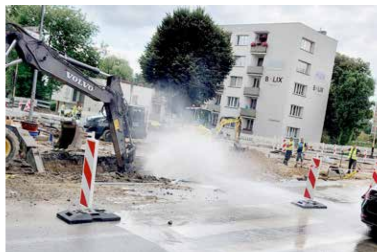
Do zdarzenia doszło w pierwszej połowie sierpnia na terenie budowy ronda. Konsekwencje pęknięcia rury doprowadzającej wodę odczuwali mieszkańcy do późnych godzin wieczornych. Potrzebne było nawet chlorowanie wody.
