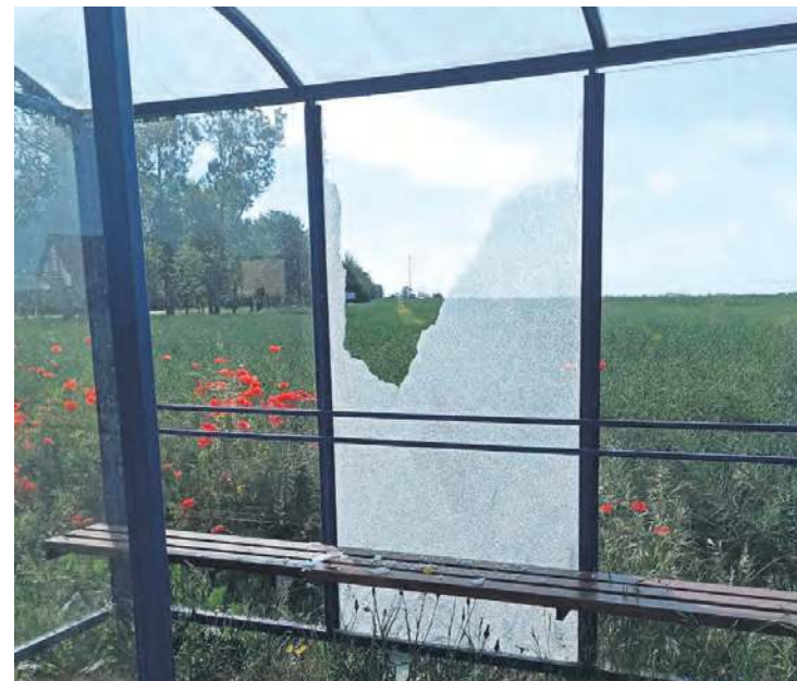
Wiatą została zniszczona prawdopodobnie w nocy z 10 na 11 czerwca.
