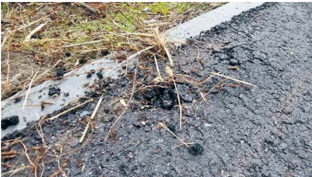
Na temat spękań nawierzchni mieszkańcy alarmowali już pod koniec ubiegłego roku.
