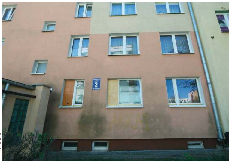
O tragedii, jaka rozegrała się w bloku przy ul. Hallera, do dziś przypominają zabite dyktą okna, które wyleciały po eksplozji w mieszkaniu
