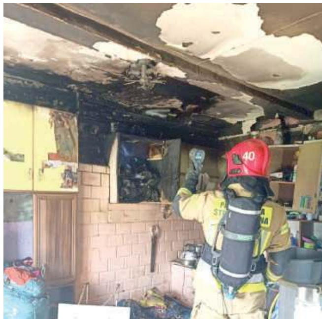
Straty wynoszą co najmniej 40 tysięcy złotych. Strażacy musieli rozebrać ścianę przylegającą do komina i pieca kaflowego oraz zdjąć nadpaloną płytę sufitową
