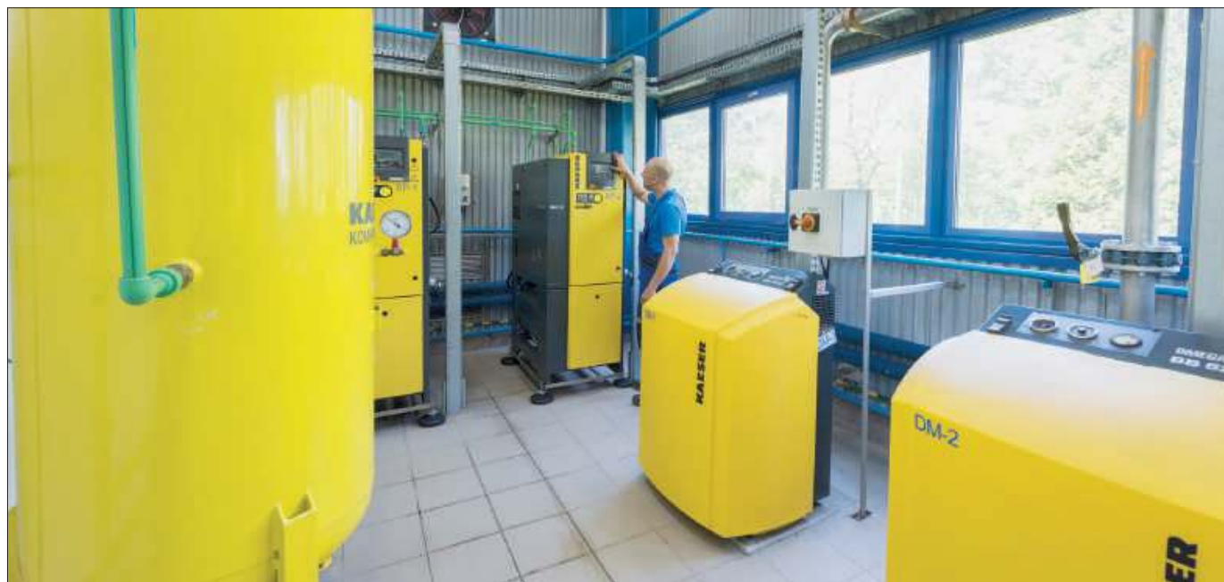
Stacja uzdatniania wody w Zabrzu Mikulczycach.
