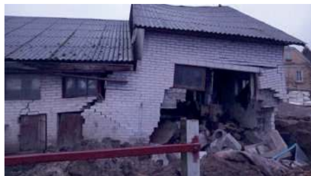
Na mężczyznę zawaliła się cała ściana wraz z fundamentem. Cały budynek miał spękane i zniekształcone ściany
