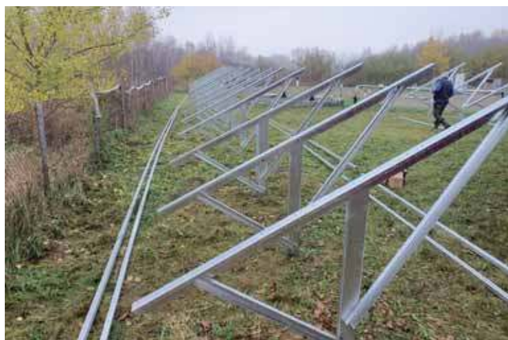
Panele powstają m.in. przy oczyszczalni ścieków
