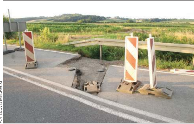
Aktualnie w ciągu ul. Granicznej w Lubomi, gdzie uszkodzeniu uległ jeden z przepustów, obowiązuje ruch wahadłowy
