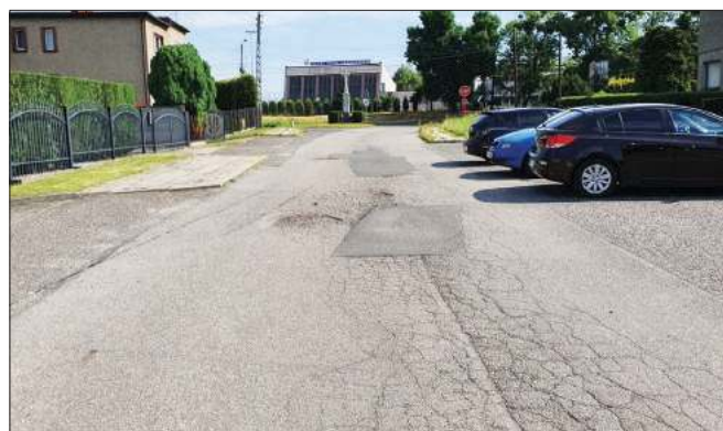
Mieszkańcy od wielu lat wnioskowali o remont ulic Sasankowej i Magnoliowej. Na nawierzchni jezdni występują liczne ubytki, spękania oraz problemy z kanalizacją deszczową.
